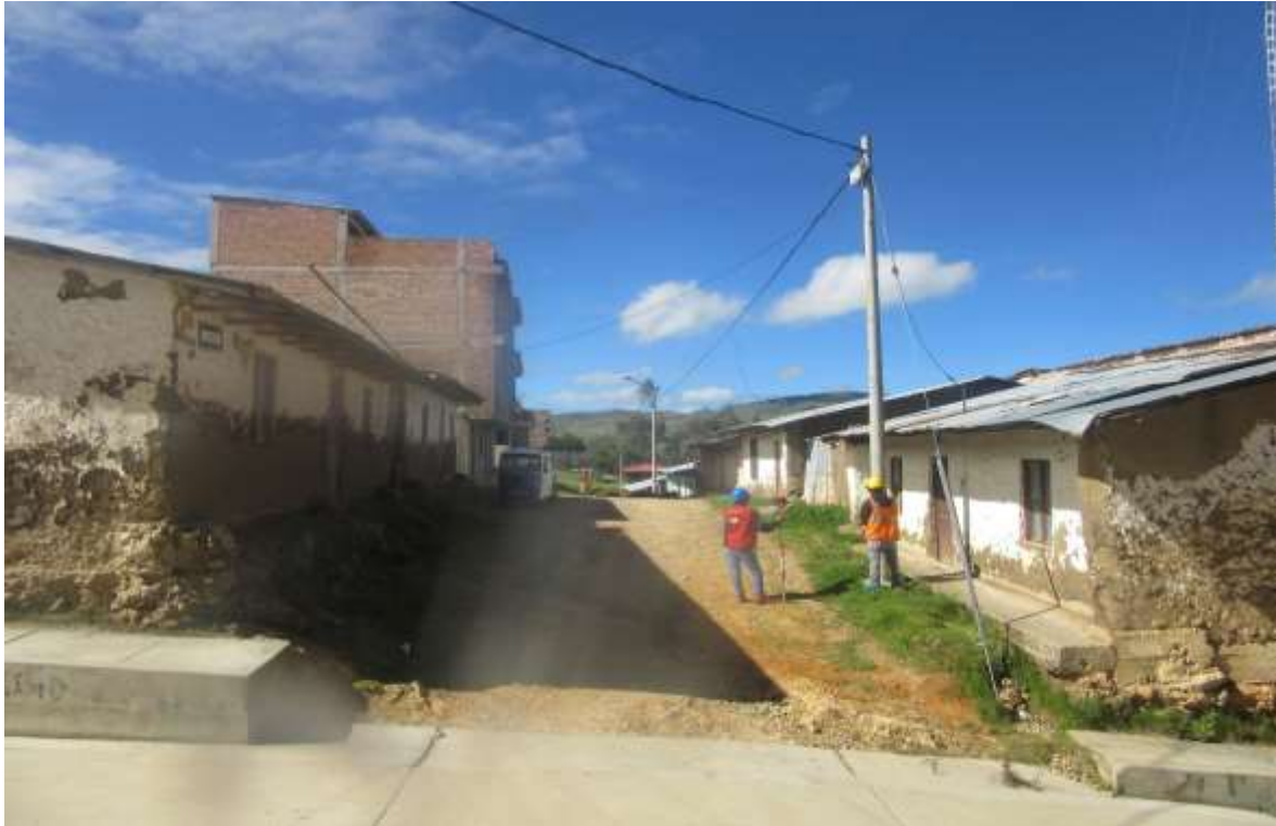
Levantamiento de Jr. Chota (vista de Jr. Cajamarca hacia Jr. Los Andes)
