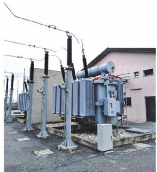
Figura 1.9 Trasformatore di gruppo e relativi scaricatori
