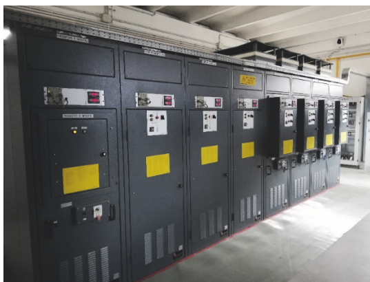
Figura 1.18 Il complesso celle misura e negativo + sezionamento di gruppo e filtro + 4 alimentatori
