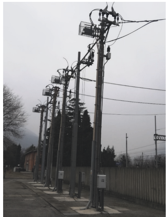
Figura 1.21 Pali di smistamento con i relativi sezionatori di 1 a e 2 a fila, gli argani di manovra e i complessi voltmetrici
