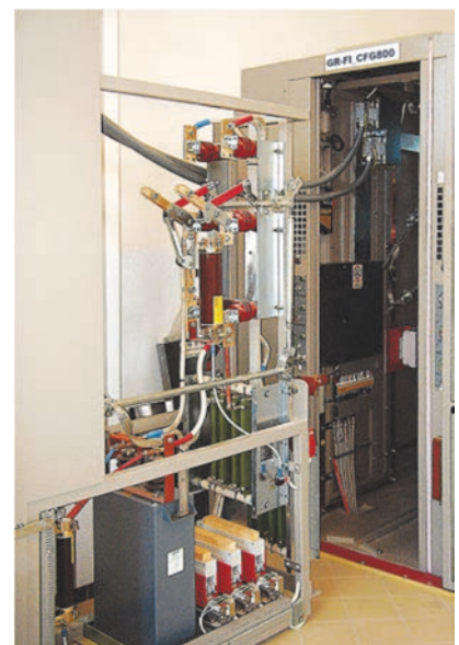
Figura 1.14 Cella sezionamento di gruppo e filtro
