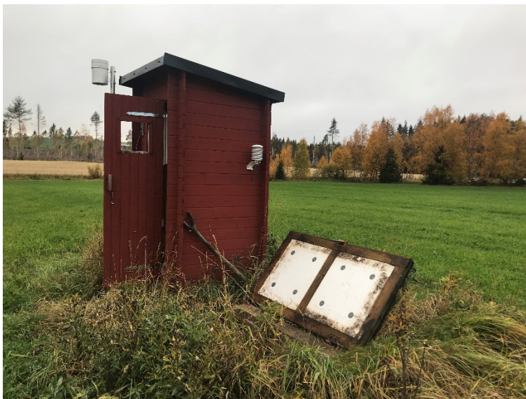
Figur 7. Mätstationen består av en nedgrävd bunker (locket uppfällt på bilden) där dräneringsvattnet passerar och flödet registreras samt vattenprover tas. I det intilliggande huset finns en logger som lagrar mätdata. På huset finns också en nederbördsräknare samt termometer. Foto: Maria Blomberg.
