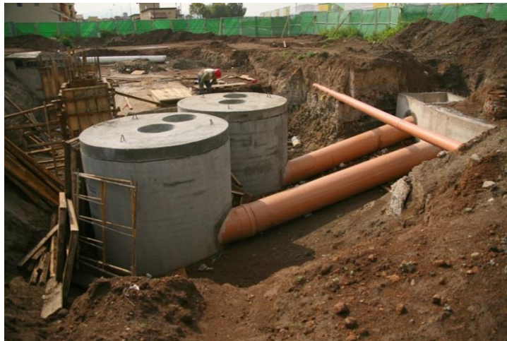
Figura 5.13. Pozos de infiltración aplicados en la ciudad de México. Fuente: Sitio web http://hidropluviales.com/
