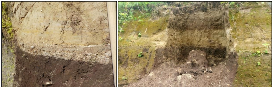
Figura 3.13. Estrato de TBJ y Flujo de escombros del Canton el Carmen y estrato con calicata para extraccion del cubo de suelo.
