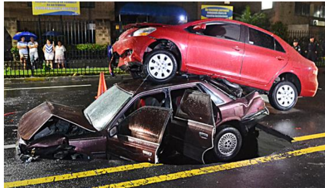
Figura 1.8. Hundimiento de pavimento Fuente: Periódico digital El Mundo 2016.
