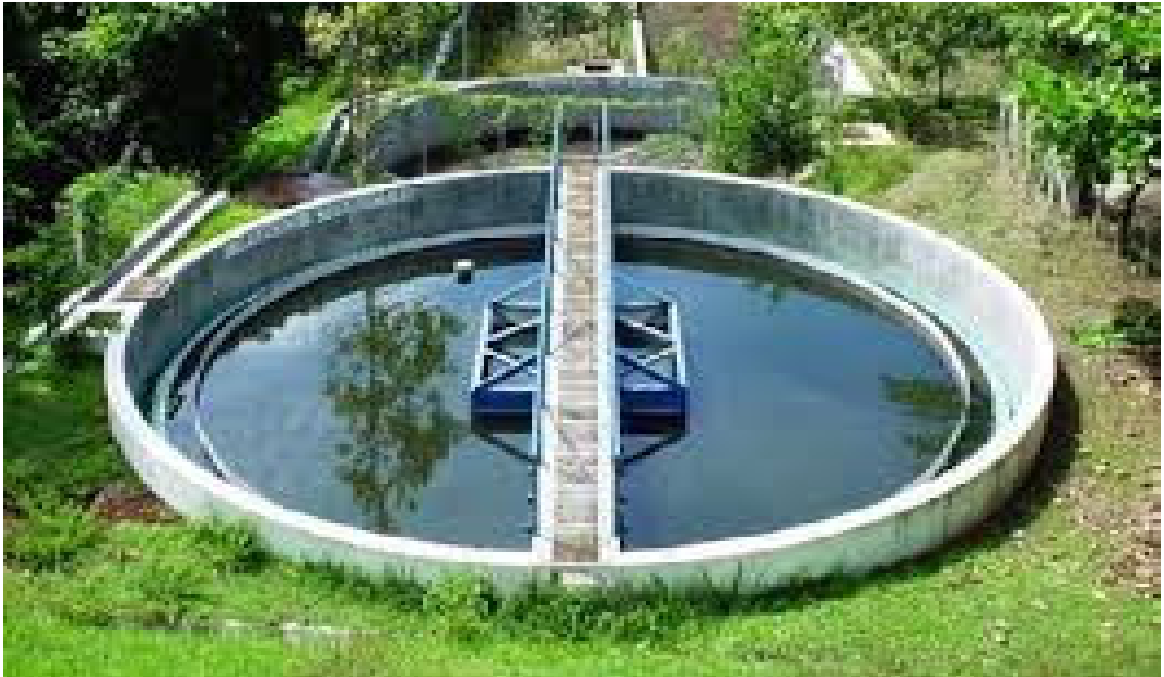
Imagen 3.3.3. Sedimentador tipo Dortmund. Fuente trabajo de graduación, Diseño del sistema de alcantarillado sanitario, aguas lluvias, y planta de tratamiento de aguas residuales para el área urbana del municipio de San Matías, departamento de la libertad, UES.
