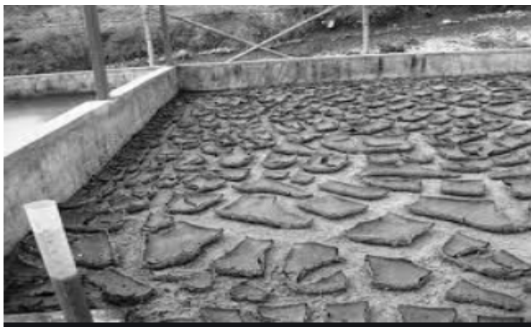
Imagen 3.3.6. Lecho de Secado de Lodos. Fuente trabajo de graduación, Diseño del sistema de alcantarillado sanitario, aguas lluvias, y planta de tratamiento de aguas residuales para el área urbana del municipio de San Matías, departamento de la libertad, UES.
