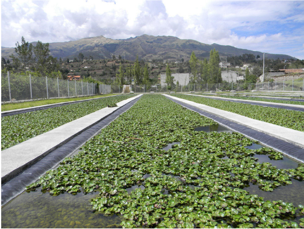
Imagen 3.3.5. Tratamiento terciario eliminación de nutrientes. Fuente trabajo de graduación, Diseño del sistema de alcantarillado sanitario, aguas lluvias, y planta de tratamiento de aguas residuales para el área urbana del municipio de San Matías, departamento de la libertad, UES.
