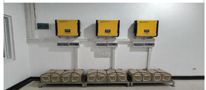
Gambar 3: Instalasi Sistem PLTS yang dibangun
