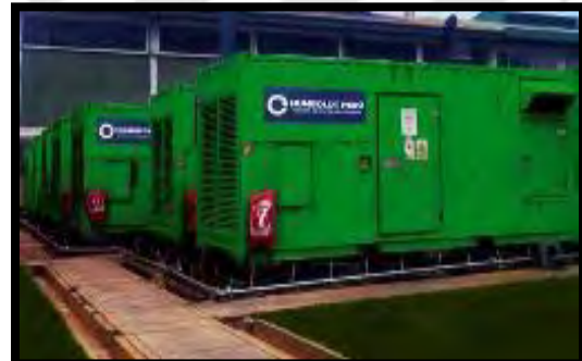
Ilustración 1: Grupo electrógeno encapsulado
