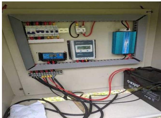
Gambar 3. Panel Listrik Sistem Pembangkitan Hybrid di JLC
