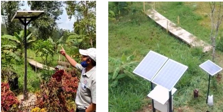
Gambar 2 Pembangunan dan pemasangan pembangkit listrik tenaga surya di Kawasan JLC Kota Batu
