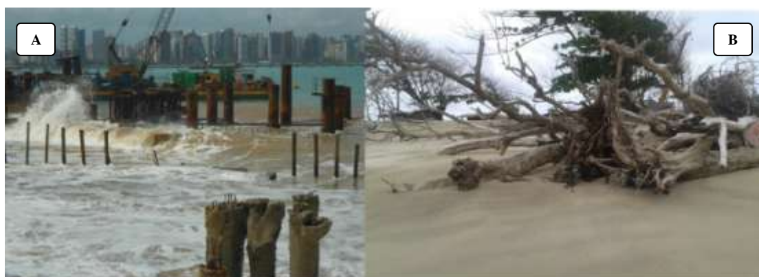
Figura 7: (A) Rebatimento marítimo no local das obras do Terminal de Passageiros. (B) Vegetação comprometida pela ação erosiva e recuo de pós-praia na Praia Mansa.
