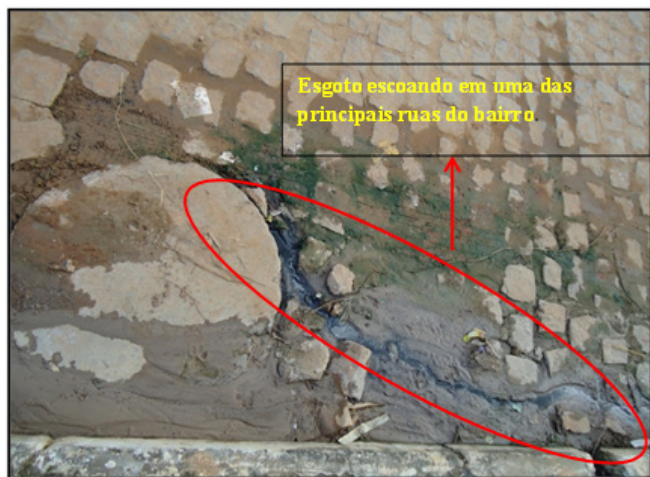
Figura 11. Vazamento de caixa de inspeção em uma das ruas do bairro. Fonte: Santos, N. X. Trabalho de campo realizado em março de 2015.
