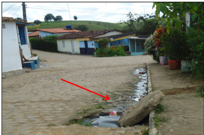
Figuras 03. Esgoto escoando por uma das ruas do bairro. Fonte: Santos, N. X. Visita técnica realizada na área de investigação. Janeiro de 2015.
