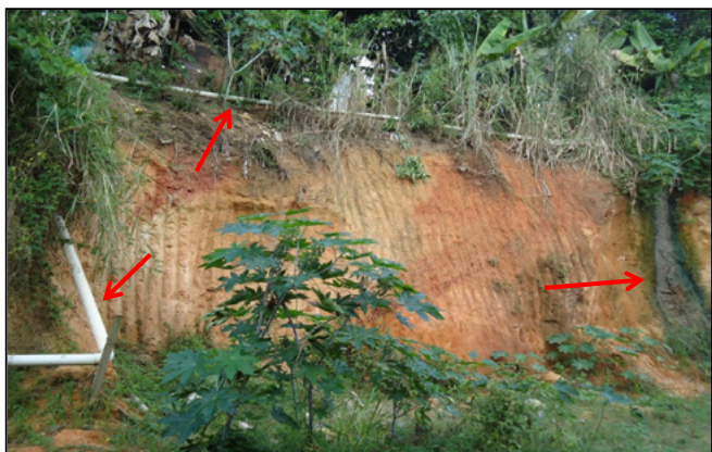
Figura 05. Rede de tubulação organizada de forma inadequada por moradores da comunidade nas encostas do bairro Santa Madalena, e escoamento a céu aberto de efluentes residenciais. Fonte: Santos, N. X. Visita técnica realizada na área de investigação. Janeiro de 2015.
