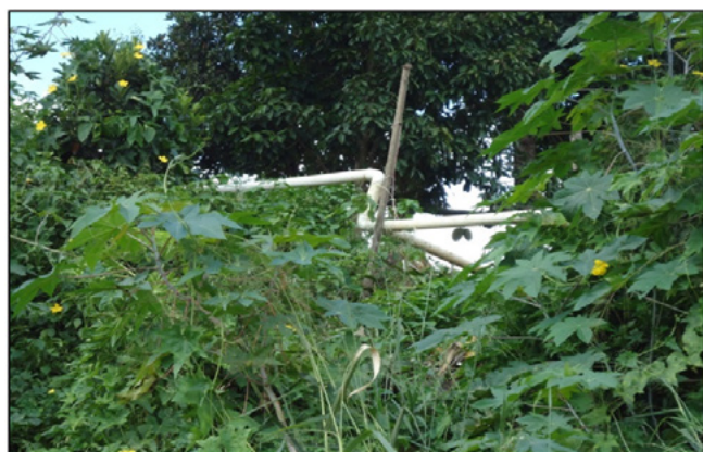
Figura 04. Encanamento de esgotos a céu aberto construído pelos moradores do bairro, que são despejados a céu aberto. Fonte: Santos, N.X.Santos, N. X. Visita técnica realizada na área de investigação. Janeiro de 2015
