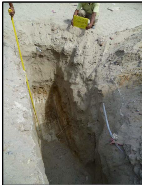
Figura N° 19. Calicata C-XIV del E.M.S. Se observa un estrato de 1m. de arena limosa suelta y por debajo un estrato más compacto.
