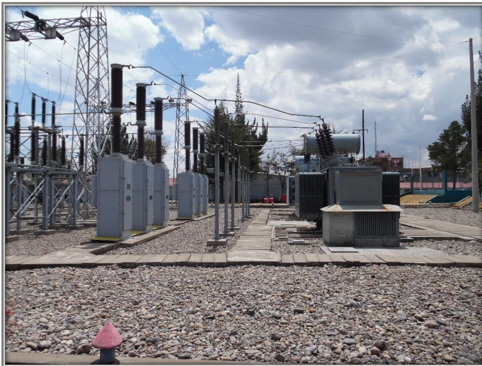
Foto N° 03: SET Parque Industrial, se observan los equipos y parte de las cimentaciones
