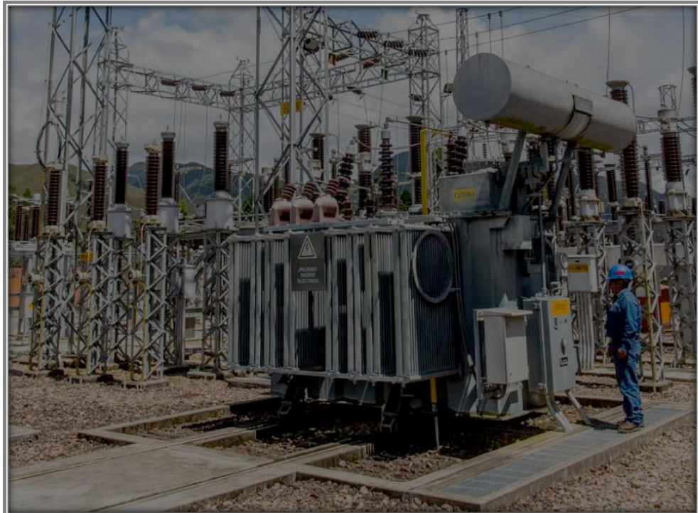
Foto N° 06: Transformador de potencia existente
