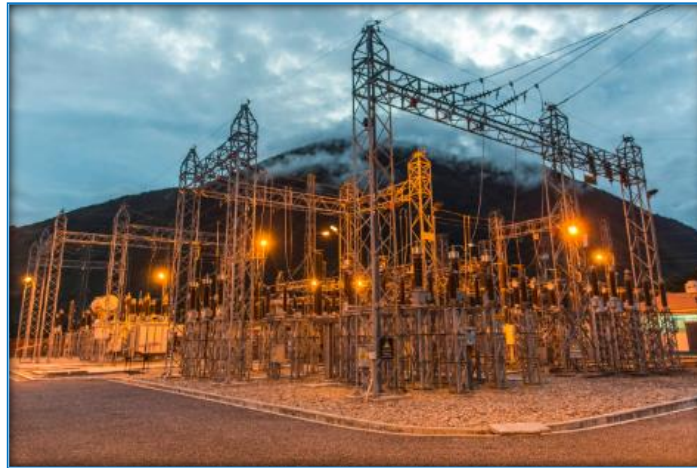
Figura. 2.7 Sub Estación de Potencia- Parque Industrial
