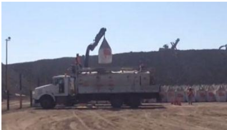
Figura 36. Operador guía el posicionamiento del big bag a la altura de la compuerta
