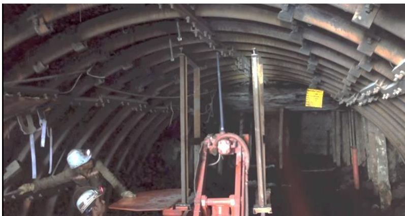
Figura 1. Cimbras en la mina El Fénix, en proceso de ser instaladas en los túneles de la mina Fuente: Mina El Fenix.
