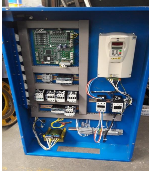
Figura 33: Ensamble de Tablero de Control.
