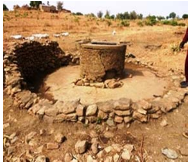
Figure 4 : Impact de l'inondation sur l'Infrastructure d'un puits
