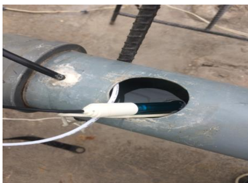
Figura 27-3: Sensores sumergidos para verificación de lectura y comunicación.
