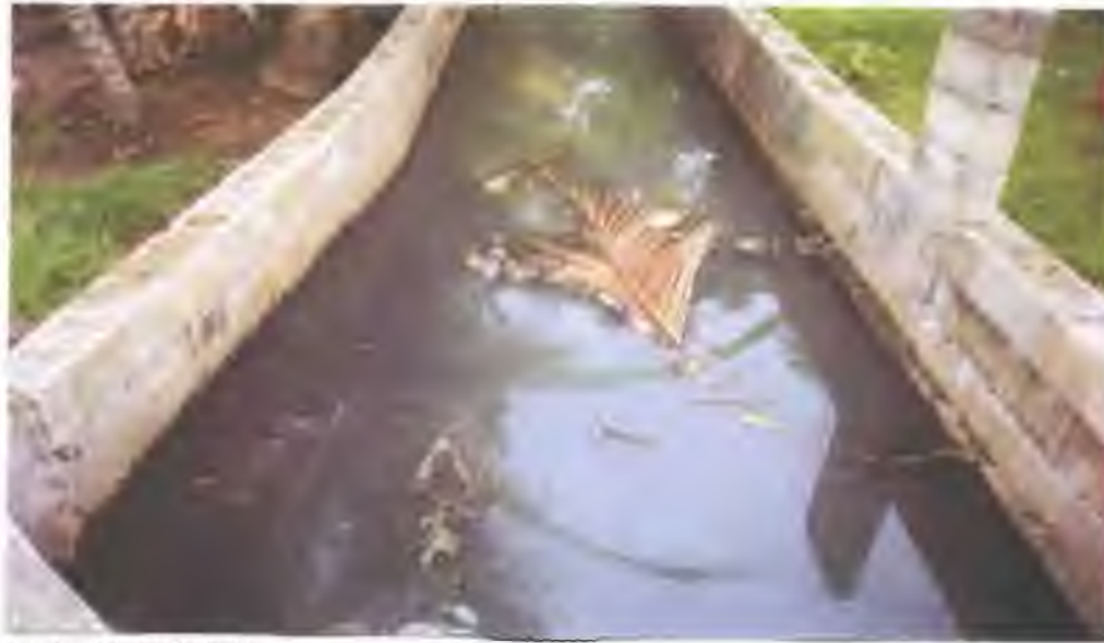
FIGURA N°26 ZANJAS COMPLETAMENTE EN ESTADO DE CONTAMINACIÓN
