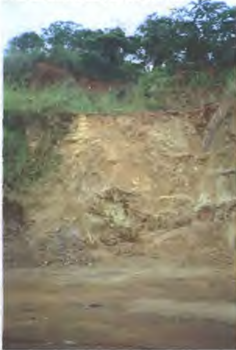
Figura N°34 DESLIZAMIENTO DE TIERRA EN MARÍA SOTO
