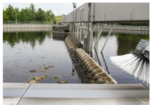
Kläranlage Freiberg (Kapazität: 10.000 EW) Aufgabenträger: Freiburger Abwasserbeseitigung
