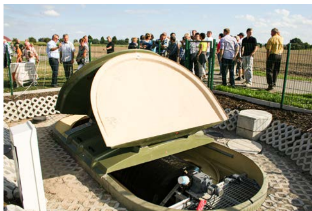
Tag der offenen Tür an der Gruppenkläranlage Treptitz (Kapazität: 50 EW) des „Vereins zum ökologischen Gewässerschutz Treptitz e.V.“, Aufgabenträger: Gemeinde Cavertitz
