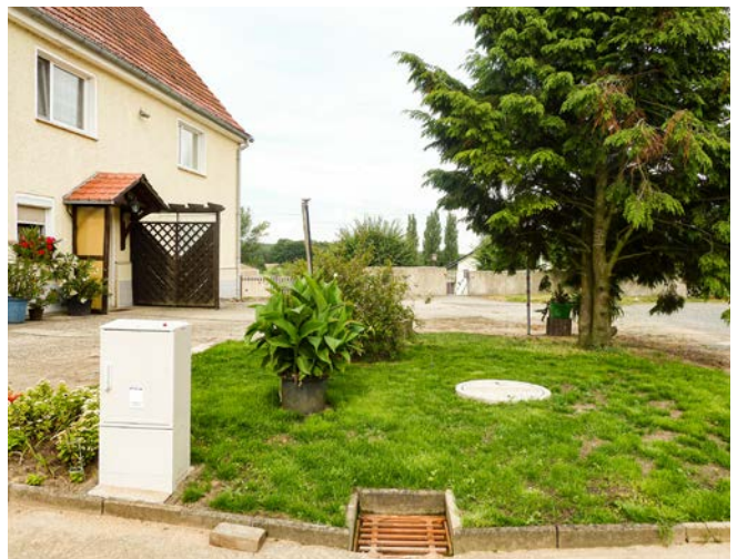
Private biologische Kleinkläranlage in Ebersbach, Ortsteil Rödern (Kapazität: 6 EW) Aufgabenträger: AZV GKA Kalkreuth
