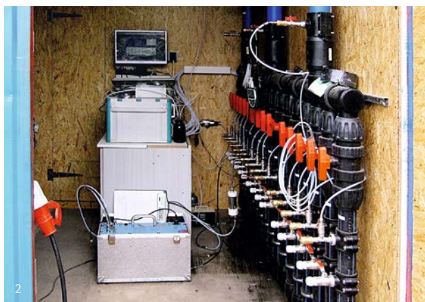
2) Apparatur der Bodenluftabsauganlage einschließlich gaschromatografischer Auswertung
