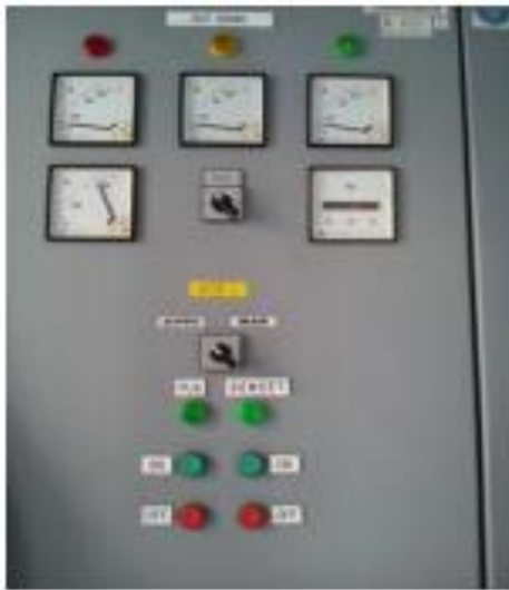
Gambar 9. ATS Tampak Bagian Luar
