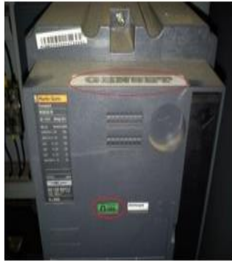
Gambar 11. Sensor pada Box Genset
