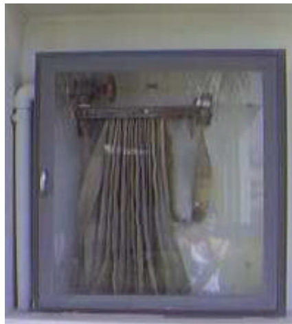
Manguera contra incendios
