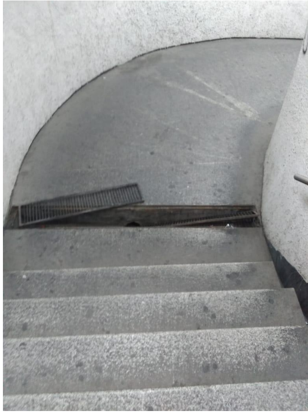
Imagen 9. Daños en la infraestructura. Entrada de la estación Zaragoza.
