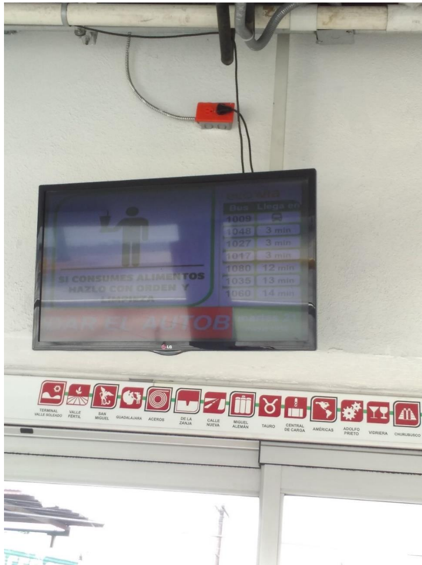
Imagen 14. Infraestructura. Monitor con tiempos de espera. Sistema Ecovía.
