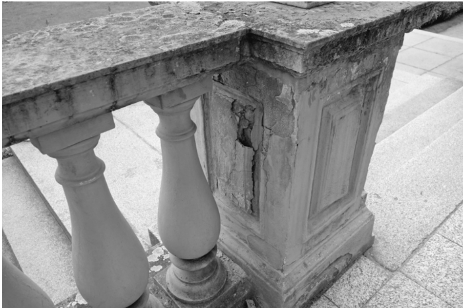
2 Fortgeschrittene Schäden in Branitz. Frühzeitige Detektionsverfahren für vorausschauende Maßnahmen im Rahmen eines Erhaltungsmanagements: (G1) (G3) (G4) (G5) (M1) (M3) (M7) (H2) (H3) (P2) (C9).
