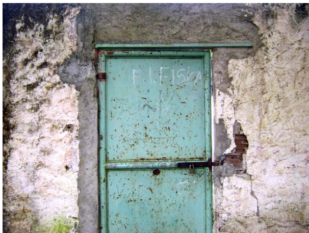
Imagem 02: Paredes furadas por projéteis com passagem para área de práticas físicas.
