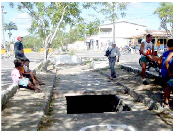
Imagem 06: Trecho do canal deteriorado: o convívio social em meio ao perigo e ao mau cheiro.
