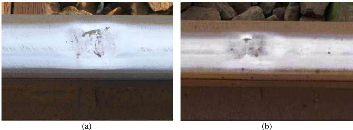
Figura 3.32 – Defeitos do tipo squat em juntas soldadas de trilho obtidas pelo processo de soldagem elétrica por centelhamento. Fonte: (a) Steenbergen e Dollevoet, 2013; (b) Steenbergen, 2008.
