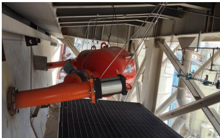
Figura 22. Canhão de ar aplicado em silo.
