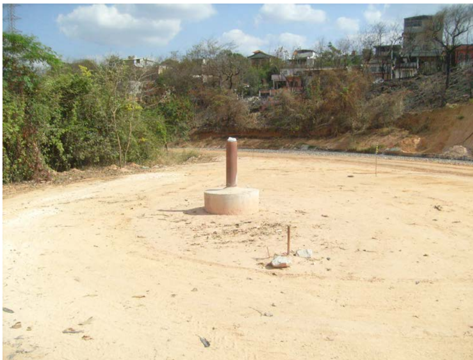
Figura 12 - Dreno de gás com redutor
