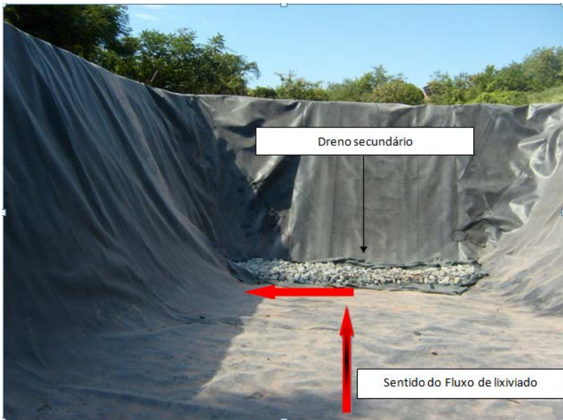
Figura 9 - Dreno de condução do lixiviado para o poço de coleta
