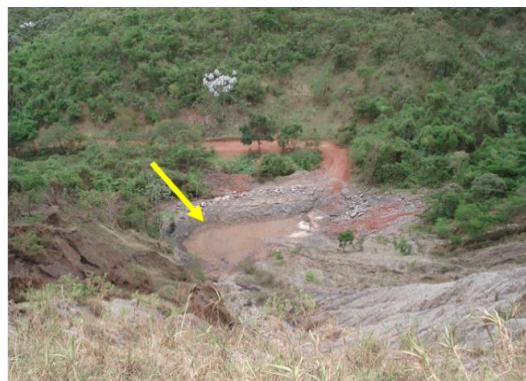
Figura 156 – Bacia de contenção de sedimentos (Sump 1), construída ao pé da antiga pilha de rejeito/estéril
