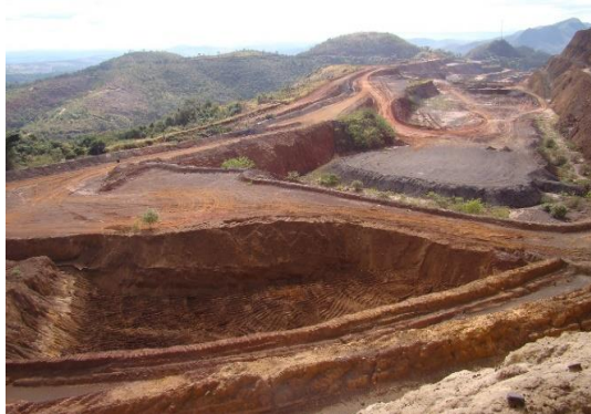
Figura 161 – Manutenção (limpeza) em bacia de contenção de sedimentos escavada em área da cava da mina à montante do local onde estava sendo realizada a lavra, antes da paralisação das atividades operacionais
