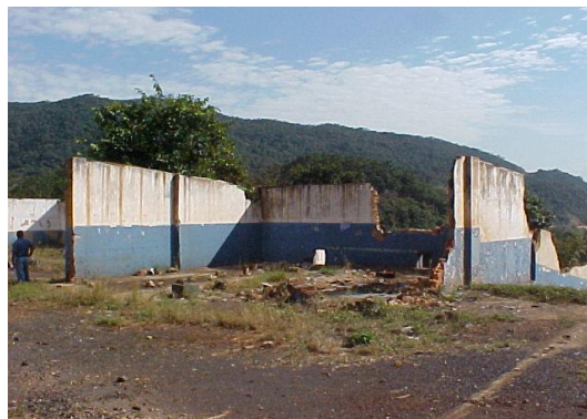
Figura 33 – Edificação depredada no pátio de administração da EMESA
