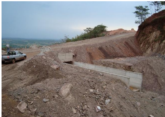
Figura 145 – Parte inicial do canal de descida d'água construído na saída da cava com a primeira galeria de transposição
