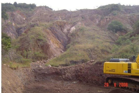
Figura 104 – Limpeza de um dique localizado imediatamente após a encosta de uma antiga pilha de rejeitos, cuja drenagem desembocava no Córrego Esperança
