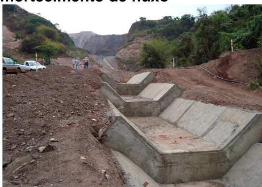
Figura 147 – Parte do canal de descida d'água construído (escada dissipadora de energia), logo abaixo das bacias de amortecimento de fluxo
