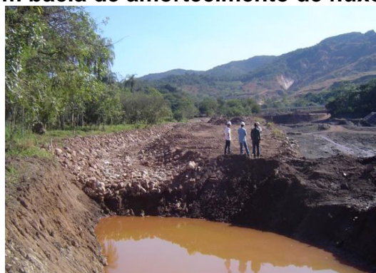
Figura 116 – Parte do canal do Córrego Esperança, mais à jusante da Adutora da COPASA, desembocando em bacia de amortecimento de fluxo
