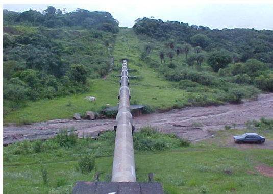
Figura 49 – Adutora da COPASA que passa pelas Glebas Candu e Esperança
