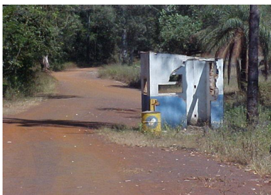
Figura 34 – Depredação da portaria do pátio de administração da EMESA
