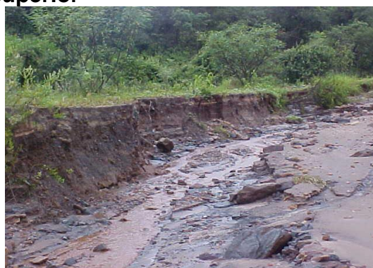
Figura 65 – Rebaixamento do nível de sedimentos imediatamente à montante da Barragem de Gabião, em decorrência das rupturas de sua parte superior
