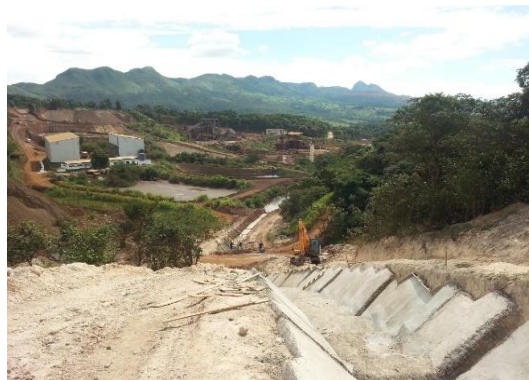
Figura 172 – Construção da escada de descida d'água na ombreira direita da pilha de estéril/rejeito, com uma das bacias de decantação ao final do canal
