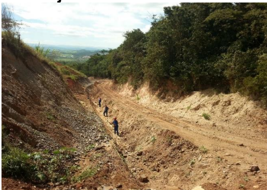
Figura 171 – Retoques manuais no canal aberto para construção da escada concretada de descida d'água na ombreira direita da pilha de estéril/rejeito
