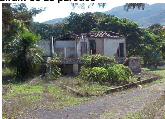
Figura 35 – Antiga residência da diretoria: após a queda do telhado, ruíram-se as paredes
