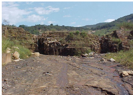
Figura 63 – Rompimento em dois pontos da Barragem de Gabião
