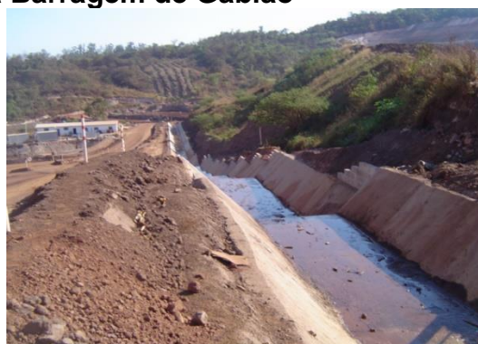
Figura 148 – Detalhe do canal de descida d'água que vai desembocar em uma bacia de contenção próxima à Barragem de Gabião
