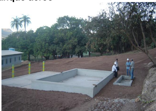
Figura 120 – Bases do posto de abastecimento de combustível que foram construídas para receber tanque aéreo
