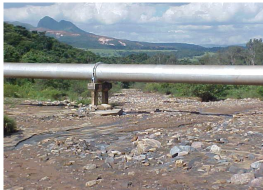
Figura 69 – Acúmulo de sedimentos imediatamente à jusante do local de rompimento da Barragem de Gabião. No detalhe, observa-se o encobrimento de boa parte da base de concreto da adutora da COPASA
