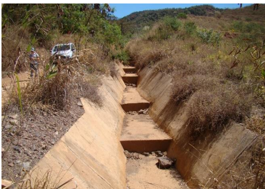
Figura 173 – Escada de descida d'água instalada na ombreira direita da pilha de estéril/rejeito
