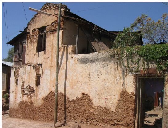
Photo 62 : La grande maison à demi-écroulée du compound Mohamed Ali, extérieur (Harar, 2008)
