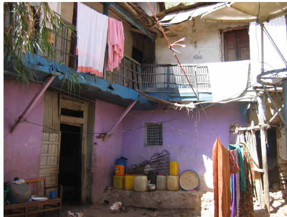
Photo 63 : La grande maison à demi-écroulée du compound Mohamed Ali, intérieur (Harar, 2008)
