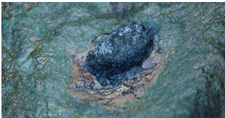
Bild 1: Dicke sulfidische Ablagerungen unter einer auffälligen Rosttuberkel im tidebeeinflussten Bereich einer Spundwand.
