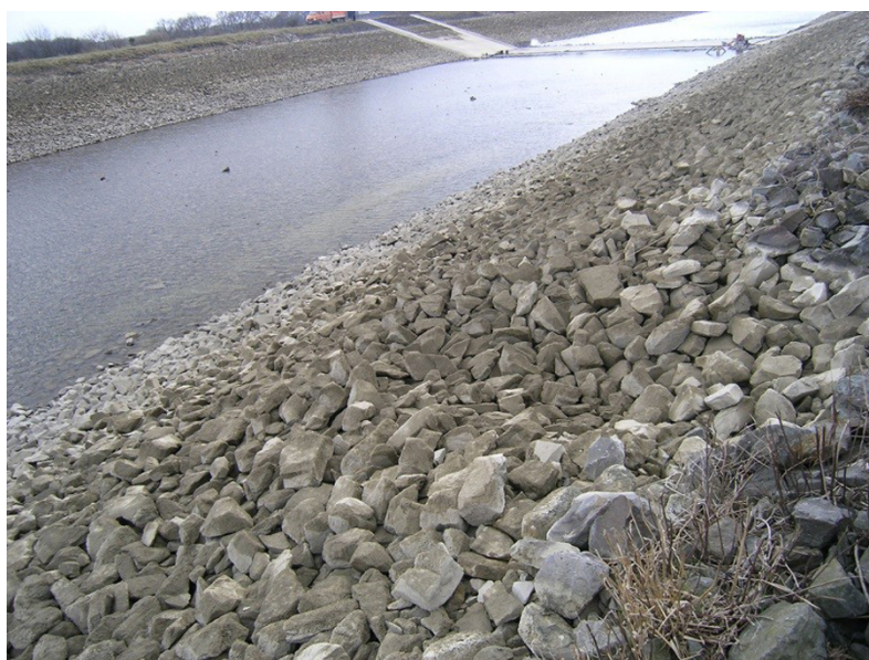
Bild 1: Beispiel für einen Deckwerksschaden infolge des Schraubenstrahls eines manövrierenden Schiffes am DEK, Los2b (2006).
