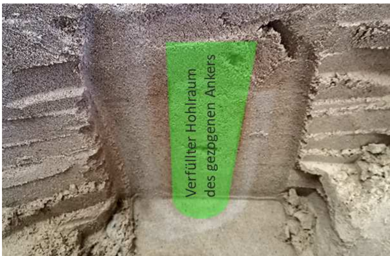
Bild 1: Freigelegter Querschnitt des verfüllten Ankerlochs mit hellerer Verfärbung im Randbereich.
