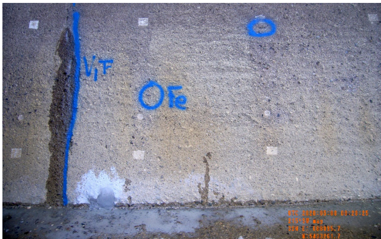
Bild 1: Beispiel für eine georeferenzierte Aufnahme von Oberflächenschäden am Beton am Wehr Dietfurt.
