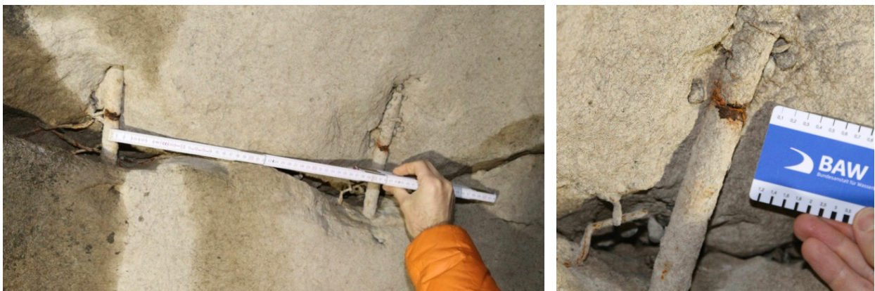
Bild 1: Durchtrennte Bewehrungsstäbe in einer geschädigten Arbeitsfuge des Umlaufkanals einer alten Schleuse (links); Nahaufnahme (rechts).
