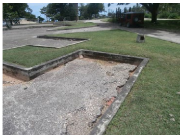
Parqueo en mal estado.
