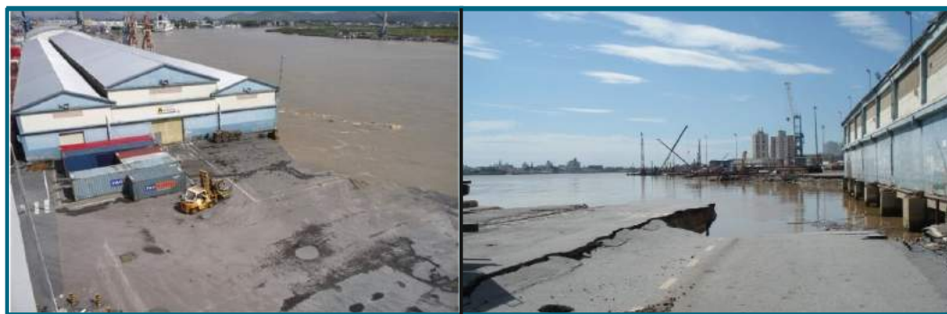
Figura 10. Danos sobre os berços de atracação do Porto de Itajaí (SC), após os efeitos de inundação no Rio Itajaí-Açu em 2008. Fonte: PORTO DE ITAJAÍ (2008).
