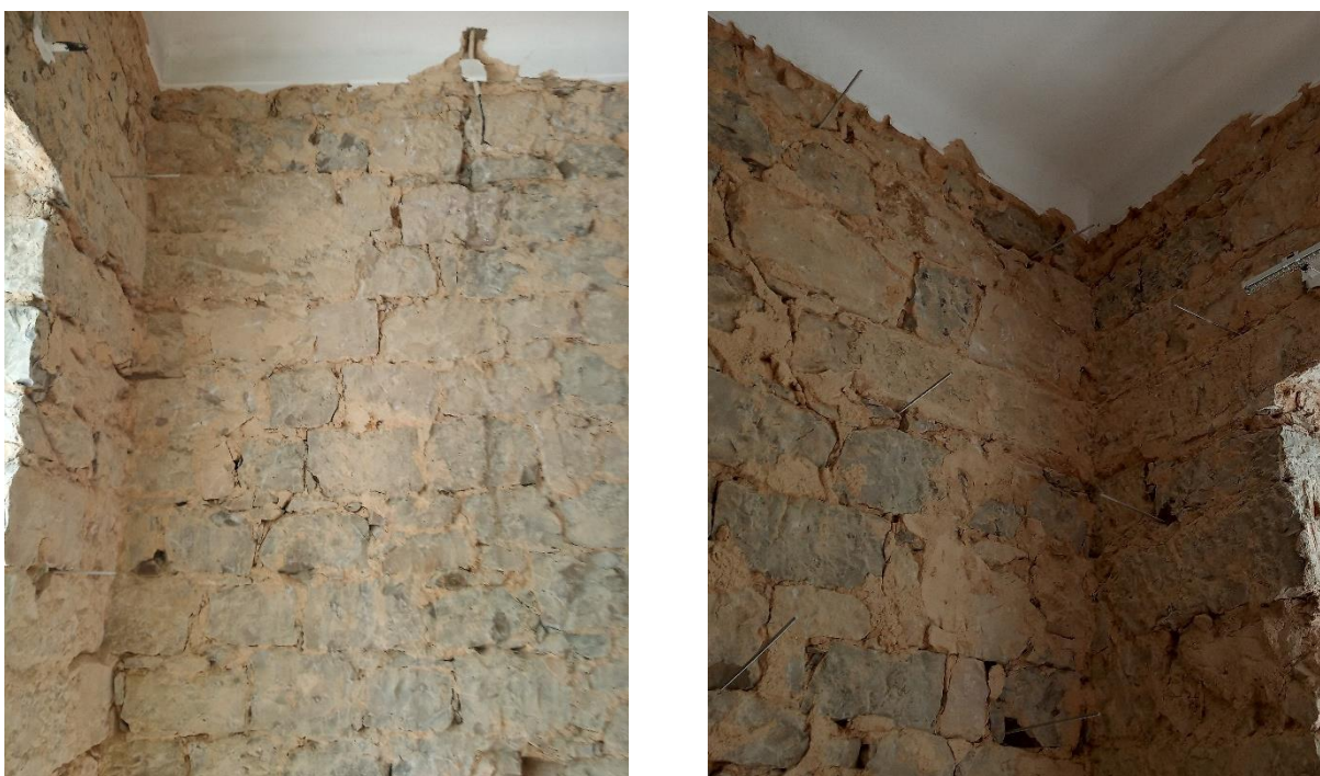
Figura 6.2: Fendas diagonais que indiciam a existência de um assentamento diferencial na parede divisória central.
