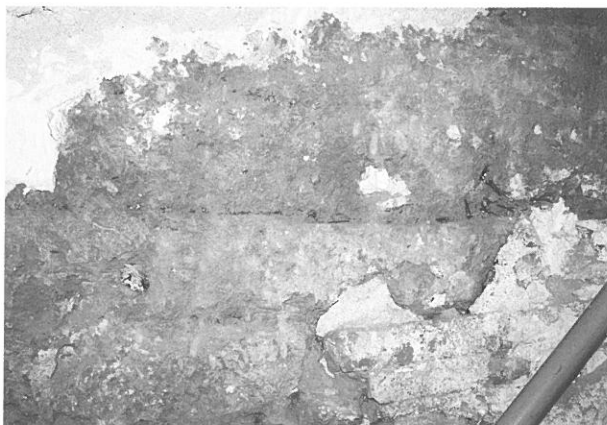
Fig. 18 : Partie du mur latéral du 5 rue de l'Hôpital, réalisé en bauge, avec des lits de bruyère.
