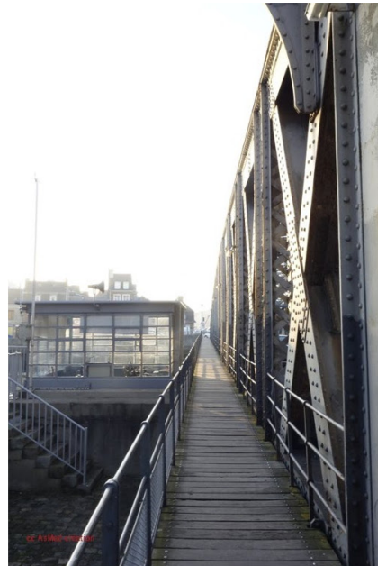
Figure 8 : vue du pont Colbert et de sa cabine de commande, cc by sa Asmad creation, 2015.
