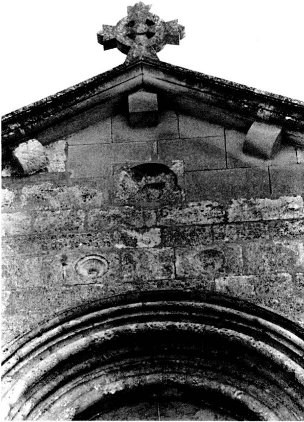
Fig. 4 : Cavités sur la façade de l'abbaye de Silvacane (Bouches-du-Rhône).
