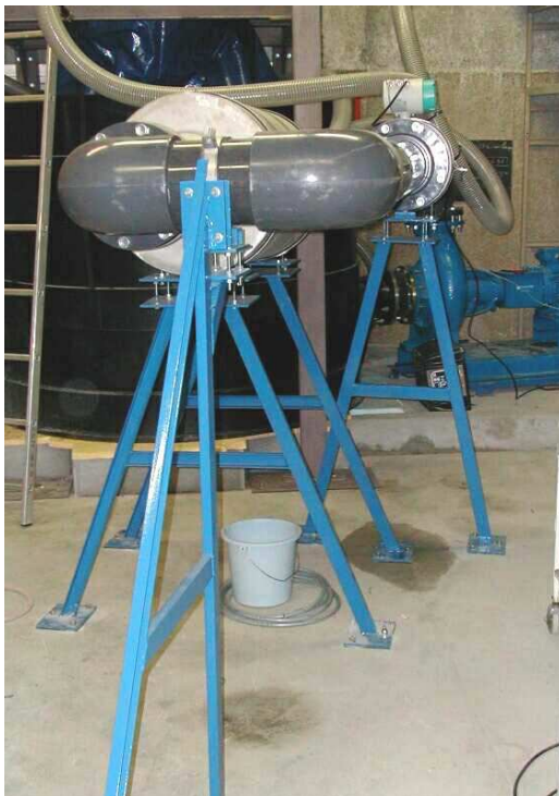
Figure 35 : vue d'ensemble de la tuyauterie rigide maintenue à environ 1,5 m du sol par 4 supports métalliques.
