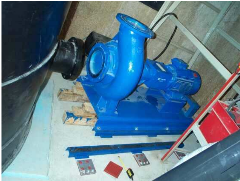
Figure 34 : Photo du haut : la pompe avant connexion avec la cuve. A sa base, les socles antivibratiles et la poutrelle chargés de la surélévation de la pompe et de son découplage avec la dalle.
