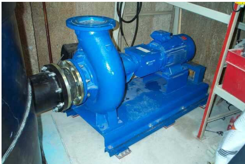
Photo du bas : la pompe est connectée à la cuve par l'intermédiaire d'un manchon compensateur.
