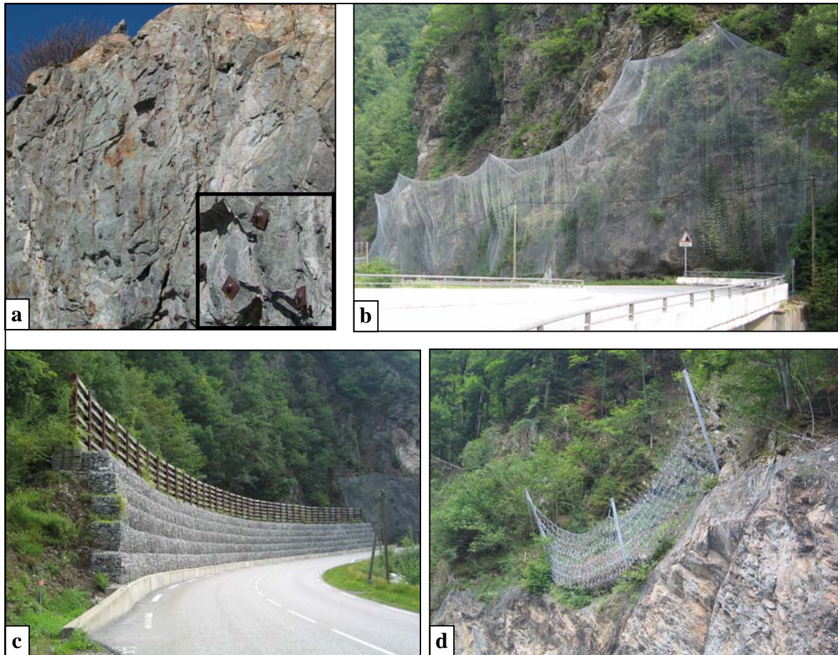
figure I.4 : (a) ancres passifs près du barrage d'Emosson en Suisse – (b) grillages de protection, (c) piège à blocs de type merlon constitué de gabions, (d) filets métalliques de protection dans le Val d'Arly (d)
