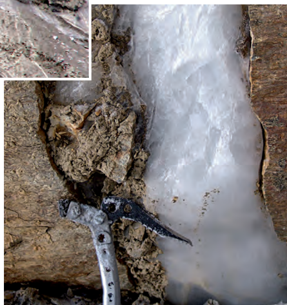
Figure 12 - Fracture du substratum rocheux remplie de glace, mise au jour par des travaux de construction sous la station du téléphérique du Stockhorn (massif du Mont Rose, 3400 m). Le remplissage est constitué de débris rocheux et de glace à gauche (piolet), et de glace pure (c.20 cm d'épaisseur) à droite.
