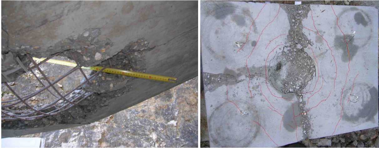
Figure II.29 : vue de dessous de la zone impactée, vue de dessus du réseau de fissures pour une énergie d'impact de 64 kJ
