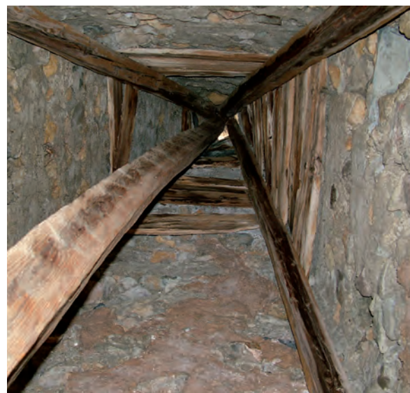
Figure 4 - coffrage de la flèche du clocher de la chapelle Saint-Romain (Puy-Saint-Vincent, 05). Photo S. Garin.
