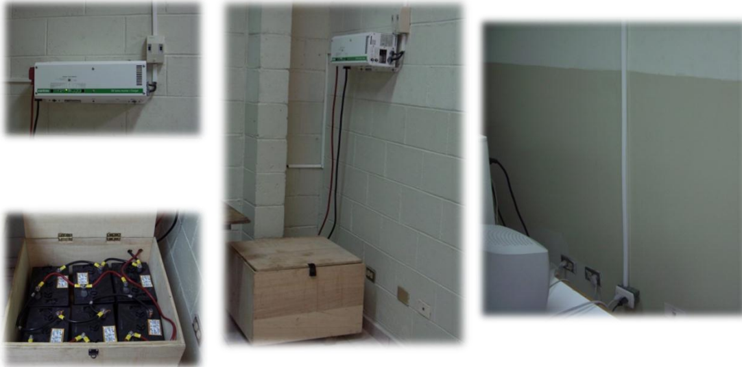
Figura -6. Sistema de alimentación ininterrumpida de energía eléctrica del proyecto.
