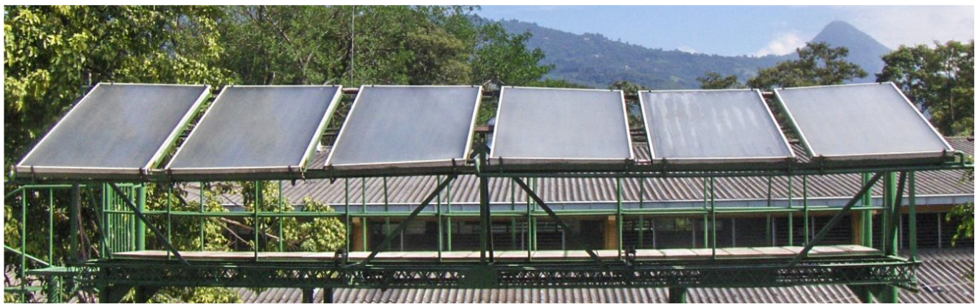
Plataforma con el sistema de colectores solares fototérmicos instalados para la Cafetería Escuela de ITCA-FEPADE
