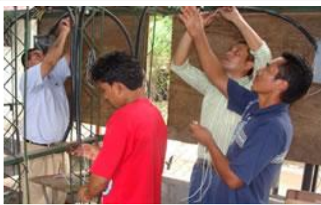
Taller de prácticas de instalaciones eléctricas residenciales efectuadas en Centro Regional San Miguel
