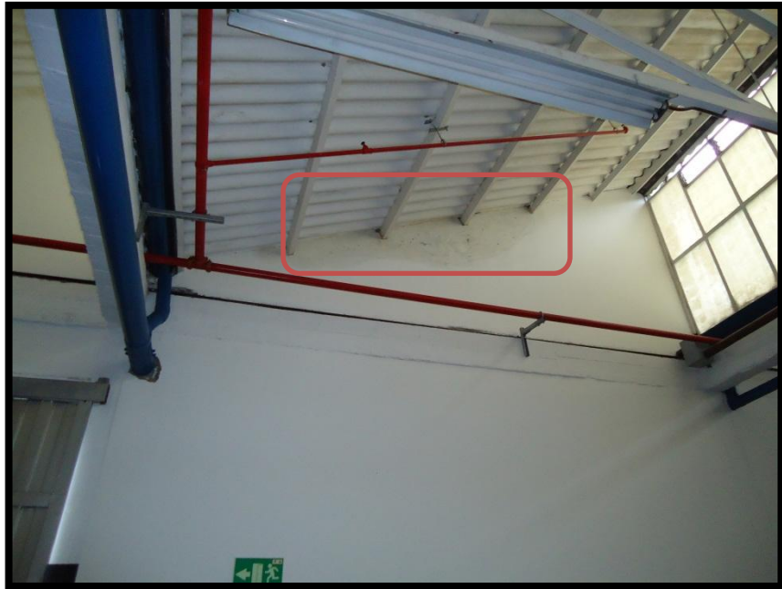
Ilustración 32 Humedad en el techo
