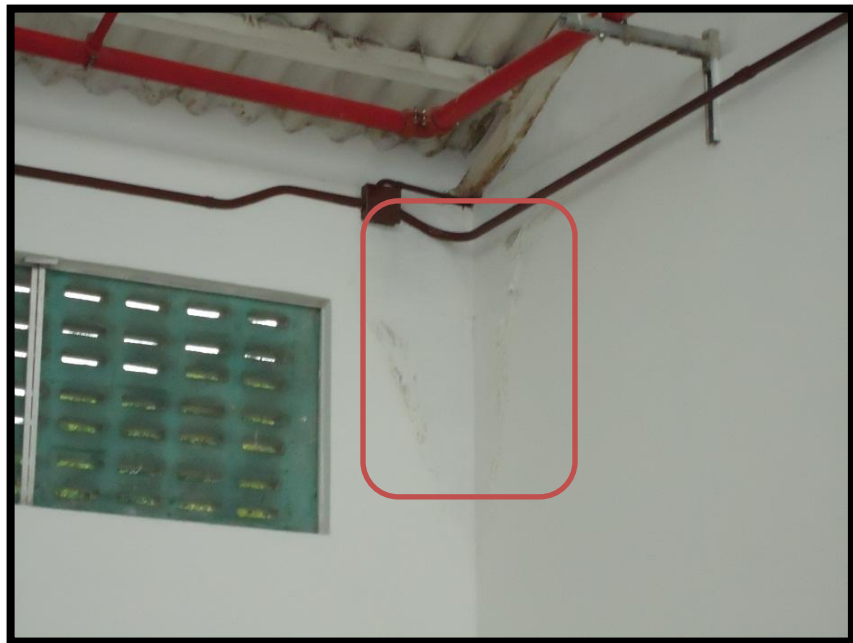
Ilustración 33 Humedad en la pared
