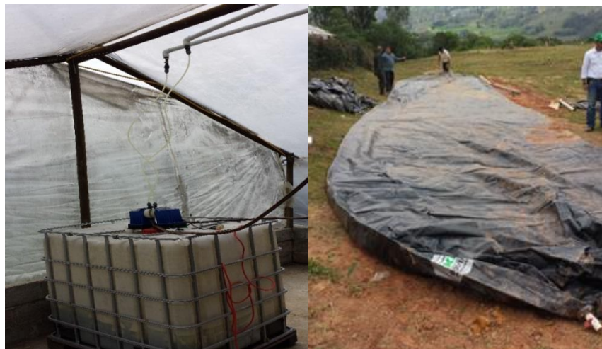
Figura 2.10. Tanque para efluente y reservorio de biogás [57].
