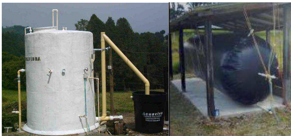
Figura 2.8. Tanque de digestión anaerobia y reservorio de biogás [7].
