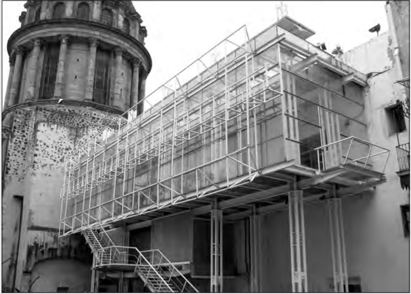
Foto 1. El antiguo convento de Santa Teresa ha sido adecuado para albergar al Centro de Arte Alternativo de la ciudad de México. Es un claro ejemplo de la integración de estructuras arquitectónicas. Esta obra de intervención realizada por el arquitecto Luis Vicente Flores integra prótesis a la arquitectura existente para poder adaptar un nuevo uso.
