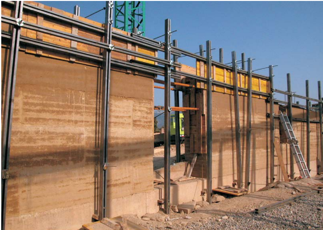
Imagen 3. Muro de tierra compactada con la utilización de una cimbra de madera.
