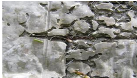
Ilustración 44. Detalle de la base, falta de homogenización de la mezcla.
