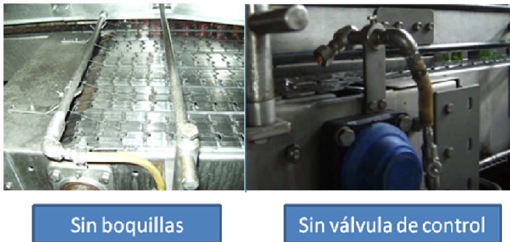
Figura 31. Ausencia de elementos de control.
